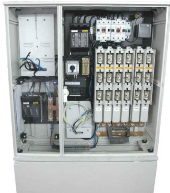
Sl. 3.4 Ormar javne rasvjete, [11].
