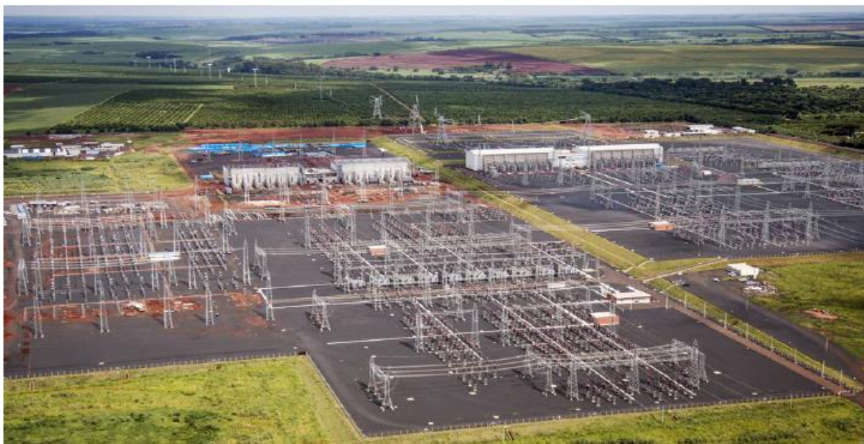
Slika 4.17. Prikaz pretvaračke stanice koja se nalazi u regiji Araraquara. [6]
