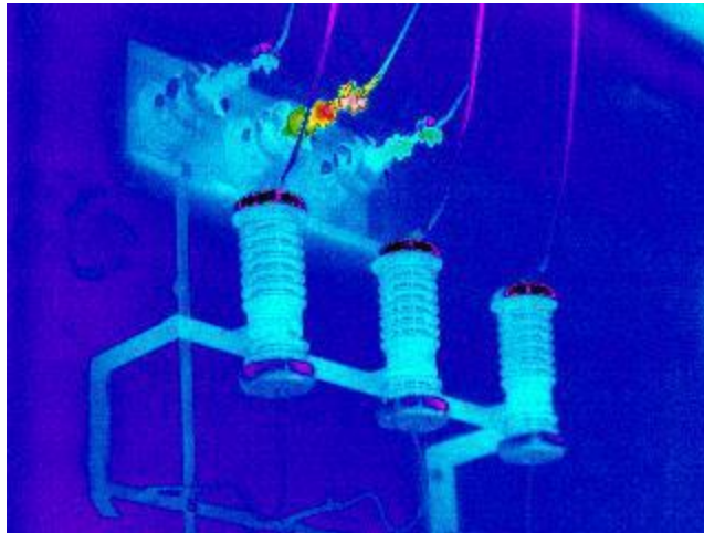
Slika 4.3.2. Izlaz 10kV iz TS na dalekovod [4]
