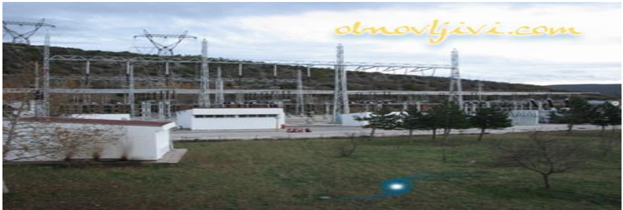
Slika 4.16. Rasklopno postrojenje RHE Velebit
