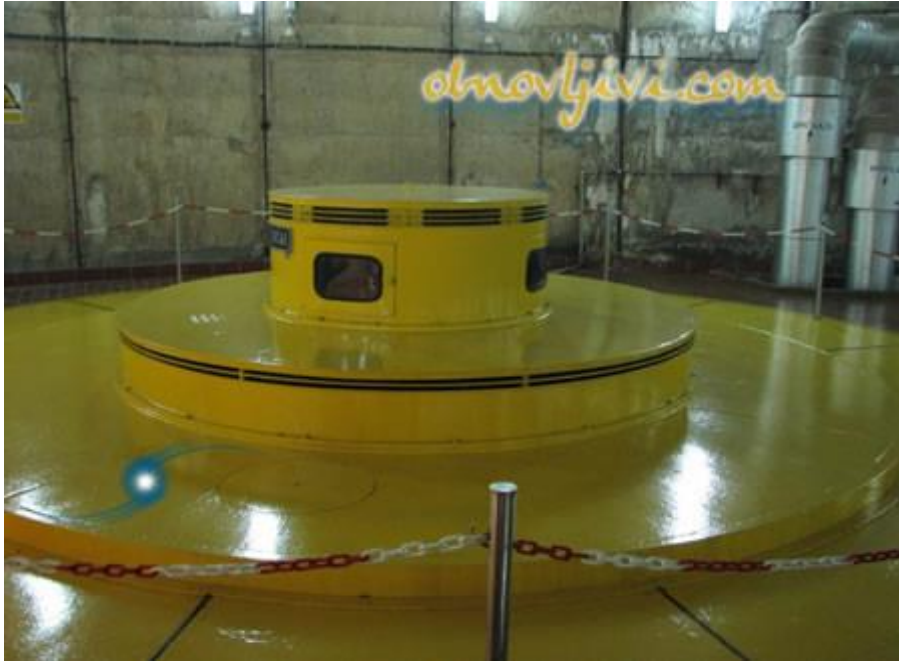
Slika 4.13. Slika prikazuje pogled (od gore) na agregat (sinkroni stroj) koji je smješten na dnu strojarnice
