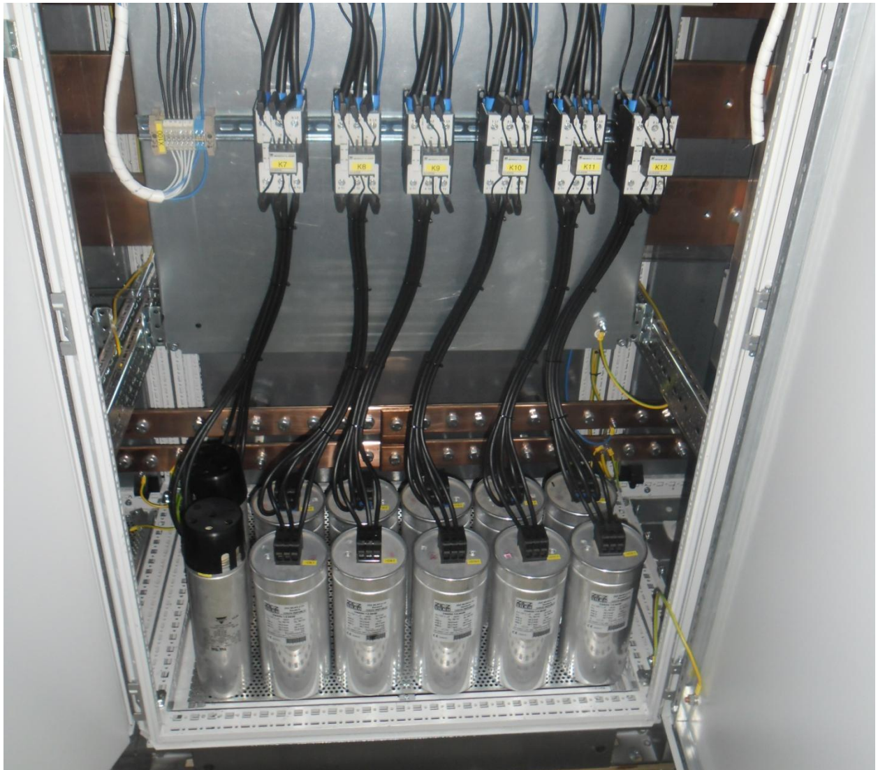
Slika 3.3. Prikaz kondenzatorskih baterija i njihovih sklopnika u niskonaponskom sklopnom bloku u polju +N3
