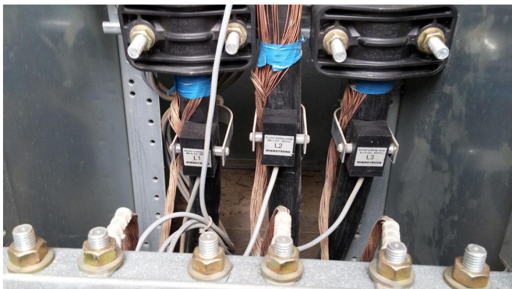
Slika 2.10. Strujni senzori montirani na kabelske završetke u razvodnom ormaru [11]
