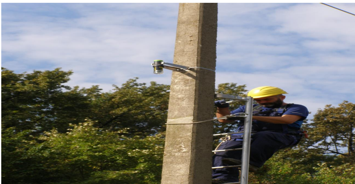
Slika 3.11. Monter prilikom montaže indikatora LineTroll 111K na betonski stup na vodnom polju ZIB
