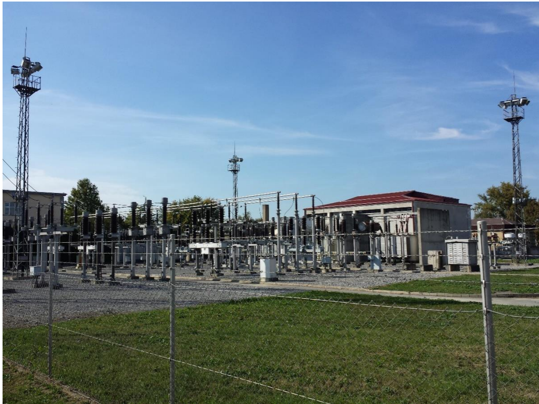
Slika 2.2. Prikaz tipične trafostanice
