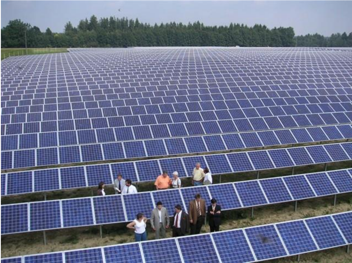
Slika 3.6. Dovršena sunčana elektrana Kanfanar snage 999kW [17]
