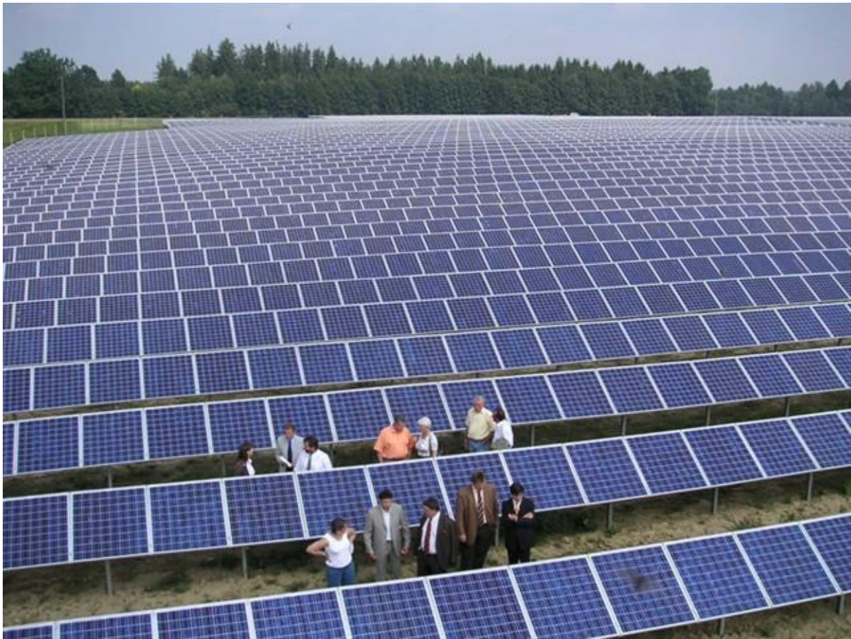
Slika 3.6. Dovršena sunčana elektrana Kanfanar snage 999kW [17]
