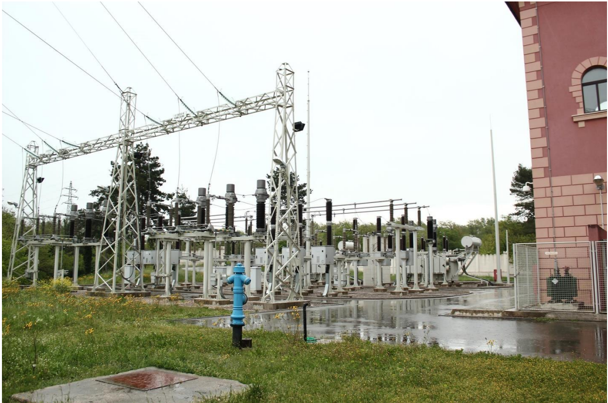
Slika 5.2. Trafostanica Vinčent 110/20kV snage 40MVA
