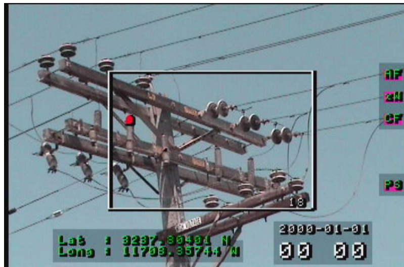
Slika 8.4. Prikaz dalekovoda UV kamerom u vidljivim bojama
