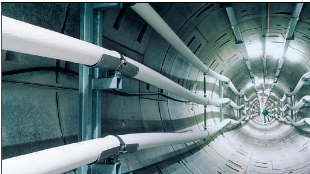
Slika 3.1. 400 kV kabelski sustav u tunelu duljine 6.3 km ispod centra Berlina
