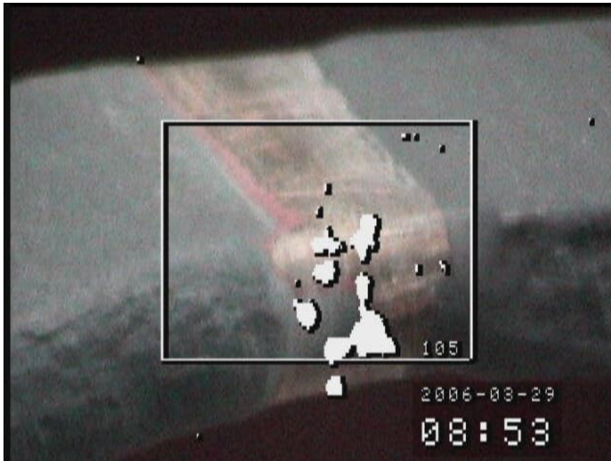
Slika 8.10. Pojava korone na sabirnicama generatora
