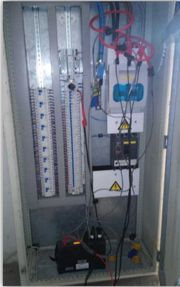
Slika 4.2. Uređaj Fluke 1745 spojen u GRO fotonaponske elektrane.
