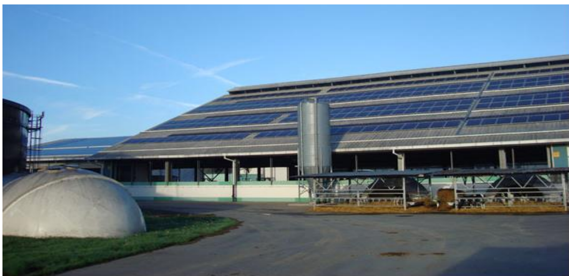
Slika 3.4. Fotonaponska elektrana Topolik.
