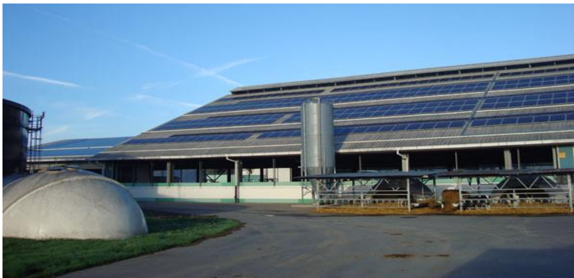
Slika 3.4. Fotonaponska elektrana Topolik.
