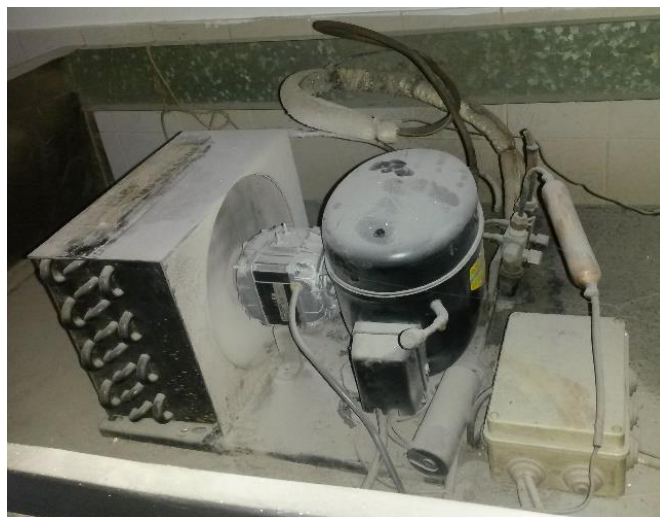
Slika 4.7. Kompresor i ventilator hladnjaka
