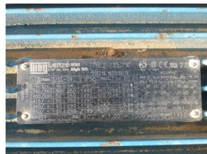
Slika 3.65. Pločica motora odsisnog ventilatora
