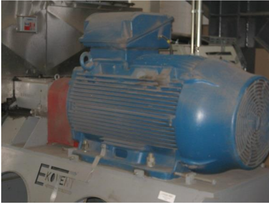
Slika 3.44. Motor usisnog ventilatora
