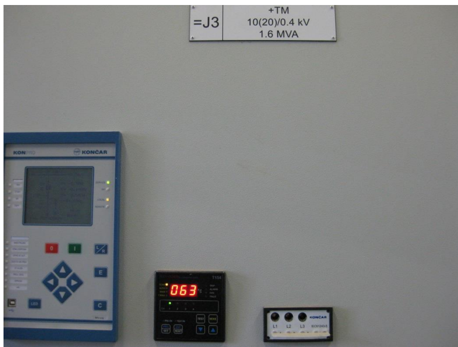
Slika 3.60. Kutija ransformatora J3 u elektroenergetskoj prostoriji
