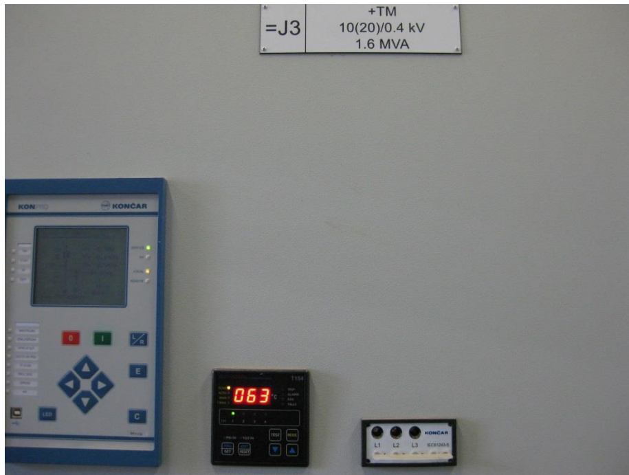
Slika 3.60. Kutija ransformatora J3 u elektroenergetskoj prostoriji
