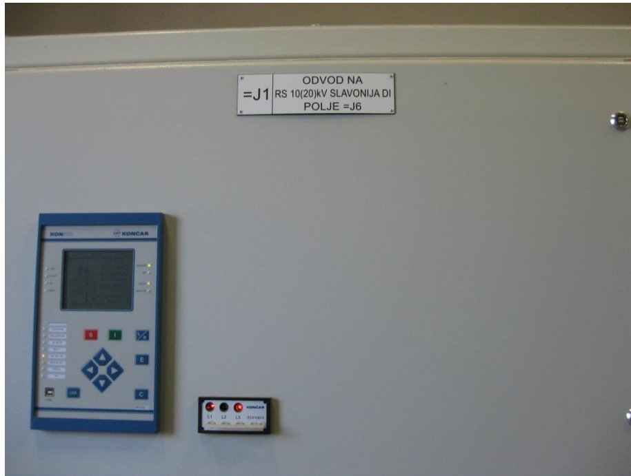
Slika 3.59. Kutija transformatora J1 u elektroenergetskoj prostoriji
