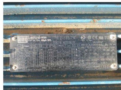
Slika 3.65. Pločica motora odsisnog ventilatora
