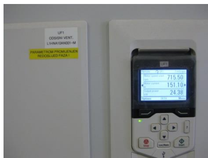
Slika 3.53. Regulator za odsisni ventilator
