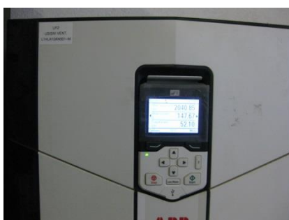
Slika 3.51. Regulator za usisni ventilator
